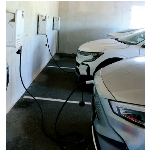
9 bornes électriques sont d'ores et déjà disponibles sur les sites TA comme ici à Aix-en-Provence
